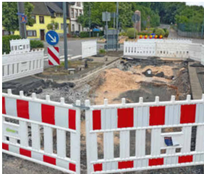
Ein Loch in der Straße und viele Fragen: Die Thematik Brückenbauwerk Birkenfelder Straße wird uns noch längere Zeit beschäftigen. Foto: Stadt Wadern/Emmy Konz
